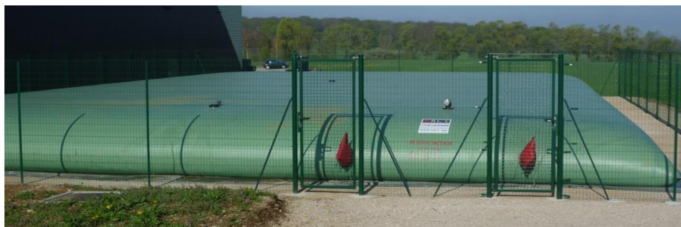
Photo 19 : exemple de citerne à eau pour la lutte incendie
