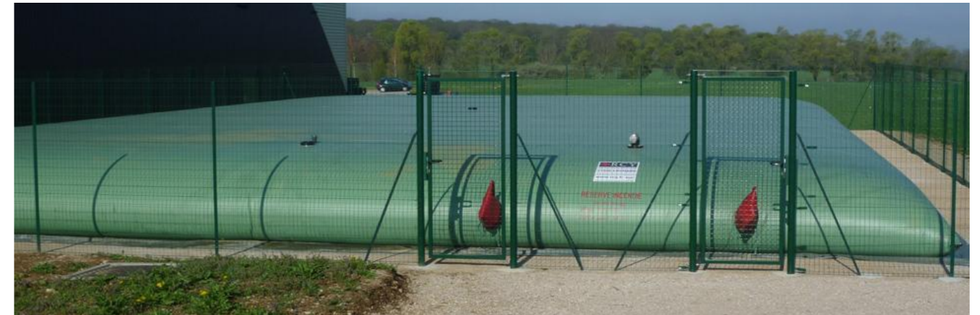
Photo 93 : exemple de bâche incendie pour la lutte incendie
