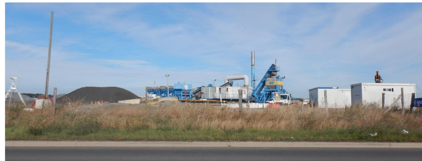
Photo 13 : centrale d'enrobage Le Foll TP
