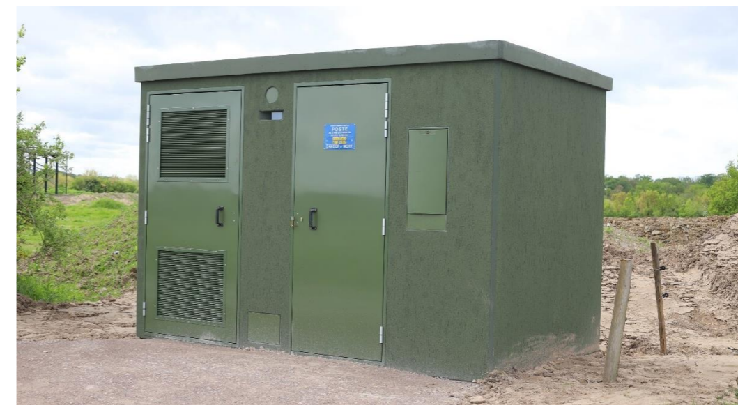
Photo 90 : Exemple de poste de livraison
