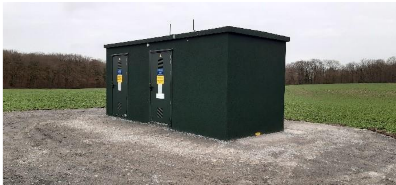
Figure 46: exemple de poste de livraison (source : Valorem)
