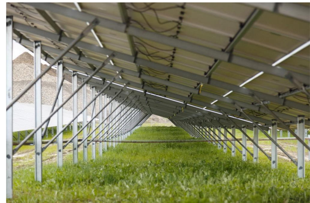
Figure 48 : Exemple de cheminement du réseau Basse Tension continu, sous les modules (source : Valorem)
